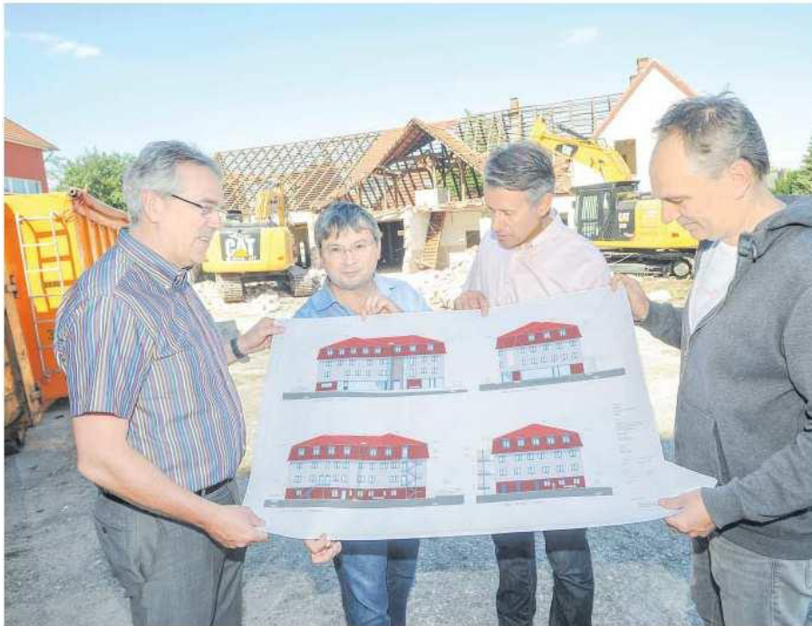
Haben den Plan: Ulf Müller (v. l.), Dieter Drunagel, Bert Honsel und Ralf Lenk freuen sich, dass es auf dem Weg zum Gesundheitszentrum Rahden mit großen Schritten voran geht. Wie der Neubau an der Ecke Hohe Mühle/Feldstraße mal aussehen wird, das zeigten sie gestern an Ort und Stelle.
