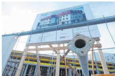
Großbaustelle: Das Gesundheitszentrum neben dem Krankenhaus ist in Bau. Für Bert Honsel ist das eines der wichtigsten Projekte in Rahden. Wie das Gebäude aussehen wird, das ist auf dem großen Schild zu erkennen.
